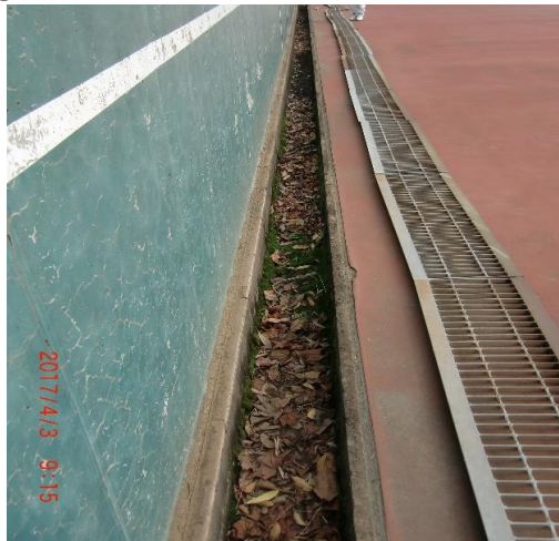
①側溝内の落葉と堆積土砂の状況
