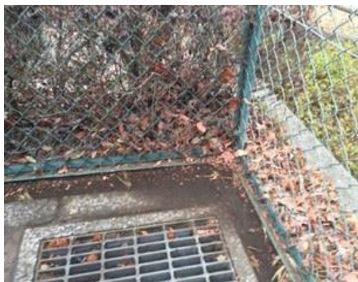
掃除後の吹き溜まり
