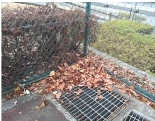
掃除まえの吹き溜まり
